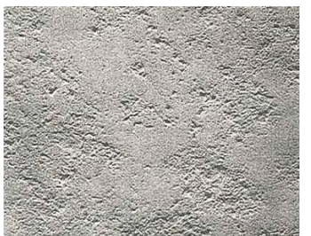
État D Sablé à Sa 3
