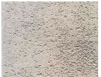
État D Sablé à Sa 2,5
